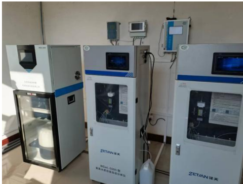
废水总排口在线监测系统
