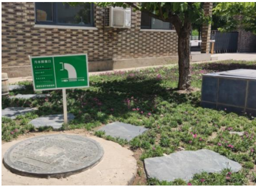
废水总排口 DW001
